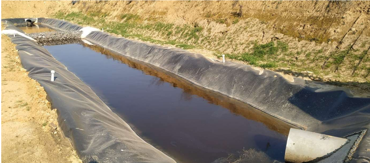
Figure 9 : Bassin de décantation
